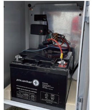
照明用パワーユニット
